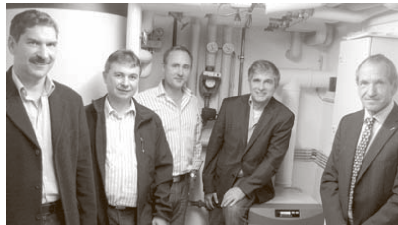
Zur Übergabe des Mikro-Blockheizkraftwerks durch den Waldshut-Tiengener Badenova Servicecenter-Leiter Otto Ebner (rechts) fanden sich im Heizungskeller von Matthias Döbele (Mitte) Stadtwerke-Geschäftsführer Horst Schmiedle (links), Heizungsinstallateur Bernd Meier (Zweiter von links) und Waldshuts Oberbürgermeister Martin Albers (Zweiter von rechts) ein. BILD: BODMER
